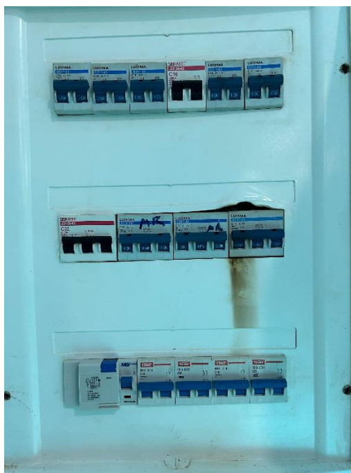
Foto 18. Prédio da CRT em Torixoréu – Sala de atendimento - Vista da caixa de distribuição elétrica da edificação. Foto em 22/08/2024.
