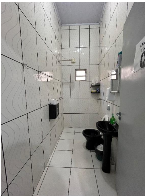
Foto 8. Prédio da CRT em Torixoréu – Banheiro masculino – Vista a partir da porta de acesso. Foto em 22/08/2024.
