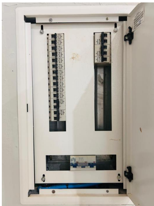
Foto 28. Prédio para locação da vistoria veicular da CRT em Sinop/ MT – Vista do quadro de distribuição elétrica da edificação. Foto em 04/02/2026.
