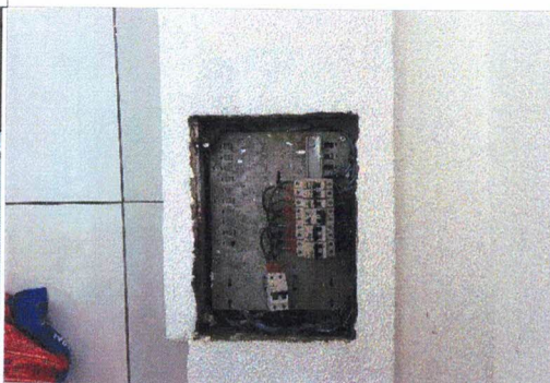
Foto 10. Quadro de distribuição 01.
