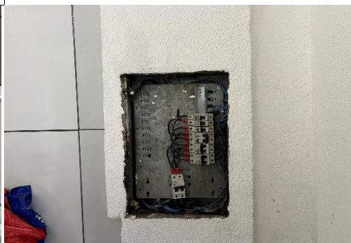
Foto 10. Quadro de distribuição 01.
