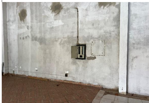
Foto 10. Quadro de distribuição 02.
