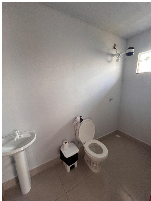
Foto 10. Pátio de Apreensão em Alta Floresta – Vista interna do banheiro da edificação. Foto em 06/05/2025.
