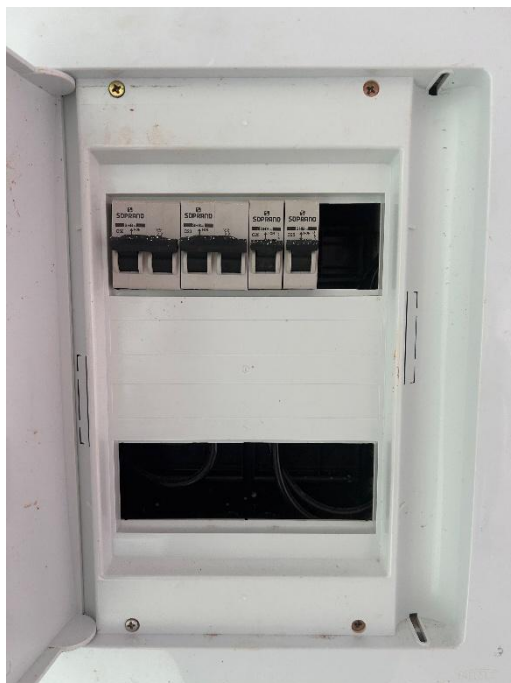
Foto 11. Pátio de Apreensão em Alta Floresta – Vista do quadro de distribuição da edificação. Foto em 06/05/2025.
