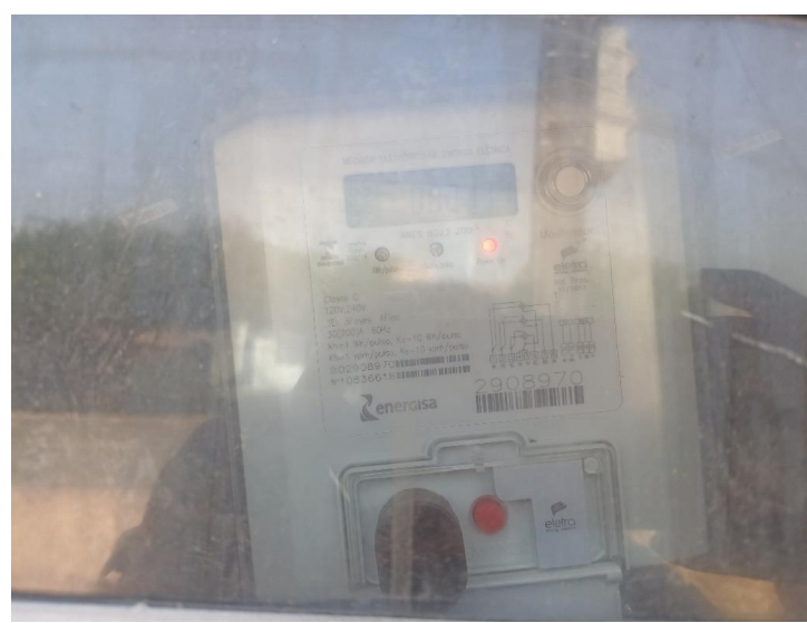
Foto 14. Prédio para Locação em Alta Floresta – Vista do relógio do padrão de energia da edificação. Foto em 15/11/2023.
