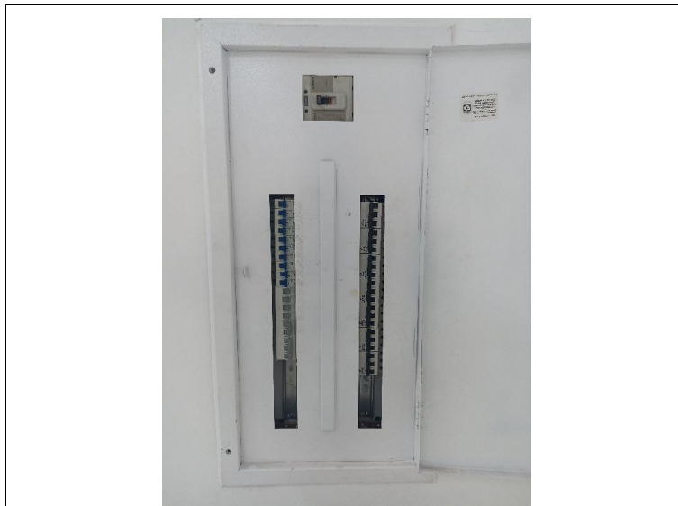
Foto 13. Prédio para Locação em Alta Floresta – Vista do quadro de distribuição elétrica da edificação. Foto em 15/11/2023.
