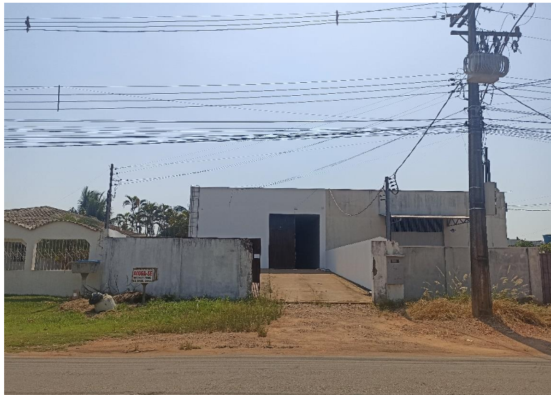
Foto 1. Prédio para Locação em Alta Floresta – Vista frontal da edificação a partir do logradouro. Foto em 15/11/2023.
