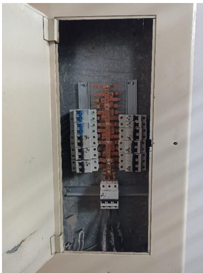
Foto 21. Prédio para locação em Diamantino/ MT - Vista do quadro 01 de distribuição de carga elétrica do imóvel. Foto em 30/06/2023.
