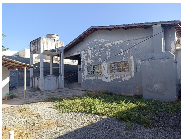
Foto 20. Prédio para locação em Diamantino/ MT – Vista do pátio dos fundos do imóvel. Foto em 30/06/2023.
