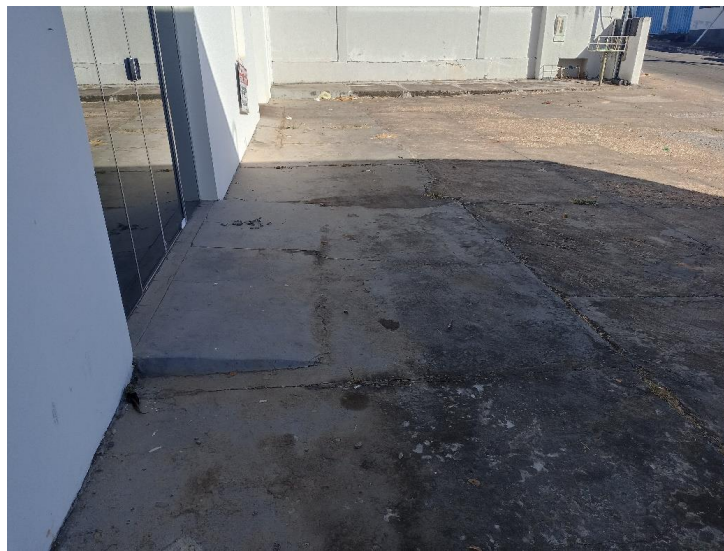
Foto 5. Prédio para locação em Diamantino/ MT – Vista das rampas nas portas frontais do imóvel. Foto em 30/06/2023.
