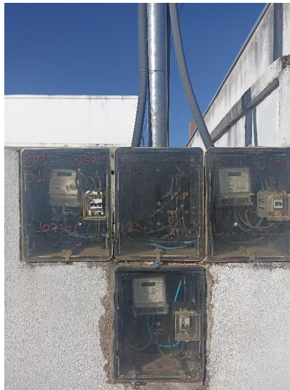
Foto 23. Prédio para locação em Diamantino/ MT - Vista do padrão de energia elétrica do imóvel. Foto em 30/06/2023.
