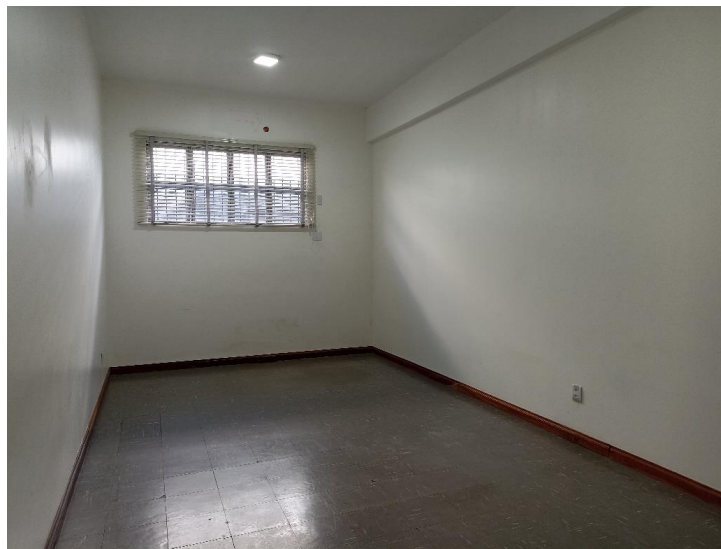
Foto 9. Prédio para locação em Diamantino/ MT – Vista da sala 02 do imóvel a partir da porta de acesso. Foto em 30/06/2023.
