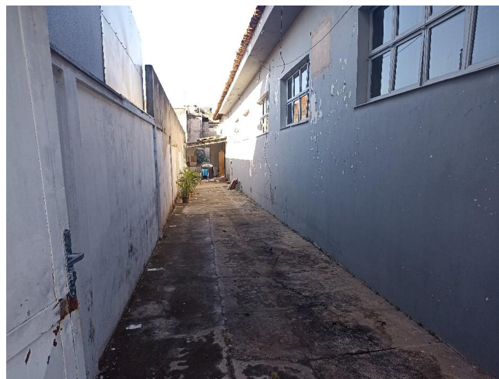
Foto 19. Prédio para locação em Diamantino/ MT - Vista do corredor direito a partir da porta de acesso frontal do imóvel. Foto em 30/06/2023.
