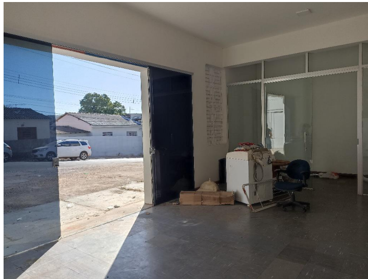
Foto 6. Prédio para locação em Diamantino/ MT – Vista da primeira sala de entrada do imóvel. Foto em 30/06/2023.
