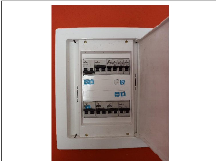
Foto 13. Prédio para Locação em Guiratinga – Copa - Vista da caixa de distribuição elétrica da edificação. Foto em 24/11/2022.
