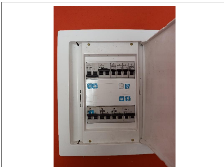
Foto 13. Prédio para Locação em Guiratinga – Copa - Vista da caixa de distribuição elétrica da edificação. Foto em 24/11/2022.
