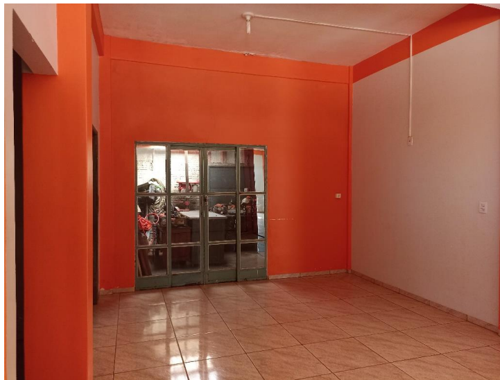
Foto 8. Prédio para locação em Brasnorte – Pavimento Térreo – Vista da porta de acesso a área residencial nos fundos da edificação que deverá ser vedado em alvenaria. Foto em 01/09/2022.
