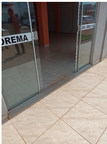
Foto 21. Prédio para locação em Brasnorte – Pavimento Térreo – Fachada da Edificação - Vista da porta de acesso a sala de atendimento ao público. Foto em 01/09/2022.
