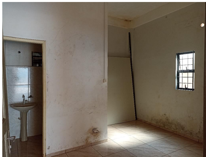
Foto 16. Prédio para Locação em Brasnorte – Pavimento Térreo – Copa - Vista a partir da porta de acesso. Foto em 01/09/2022.
